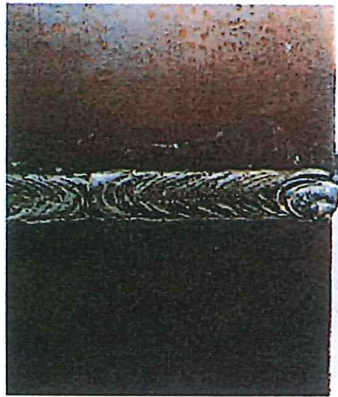
クレータ処理の不良によるもの
