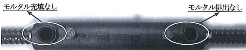
(d) モルタルの充填不足：不合格
